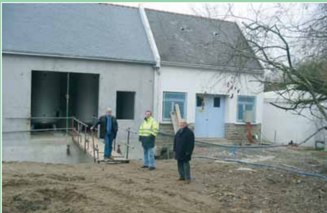
La station de traitement d'eau potable de Bossavarn
